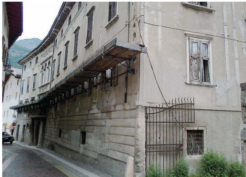
Palazzo Martini, storico edificio settecentesco di Calliano sgomberato nel 1997, sta crollando per incuria
